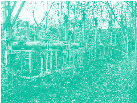
Transformateur en désuétude à Bagnolet. Source : Novaxia.
