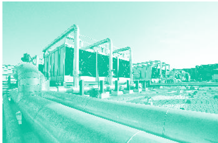
Tour de refroidissement d'un data center en Chine. Photo : WaitForLight, Shutterstock.
