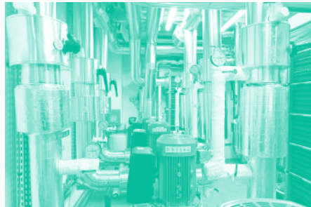
Système de climatisation d'un data center du XVIII e arrondissement à Paris (2019). Photo : Henri Garat, Ville de Paris.
