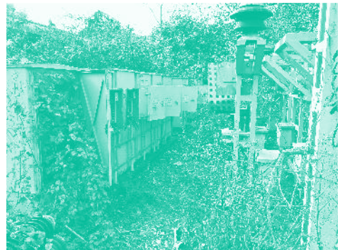
Transformateur en désuétude à Bagnolet. Source : Novaxia.
